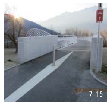
Potelet avec marquage adéquat empêchant le passage des véhicules à moteur sur la rampe.
