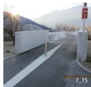
Absperreffosten mit korrekter Markierung. Der Pfosten verhindert das Befahren der Rampe mit Motorfahrzeugen.
