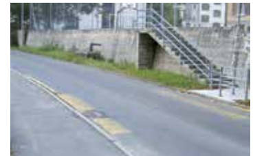
Fussgängerstreifen ist nicht mehr erkennbar.
