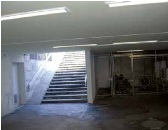
Mangelhaft ausgeleuchtete Unterführung mit schlecht einsehbaren Bereichen sind «Angstorte», die gemieden werden.
