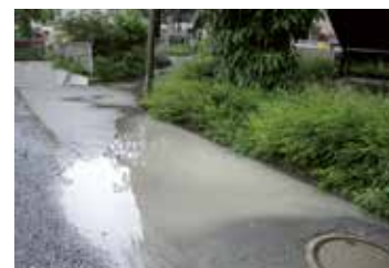
La flaque sur une portion du chemin empêche le passage.
