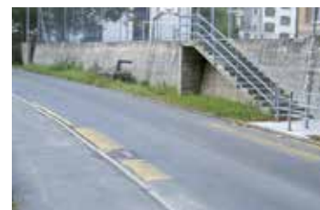
On ne distingue plus le passage piéton.
