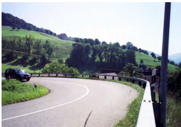
Abbildung 49 Beispiel einer Leitschranke an der Kurvenaussenseite mit doppelter Schutzfunktion (Absturz und Kollision mit einem Mast)
