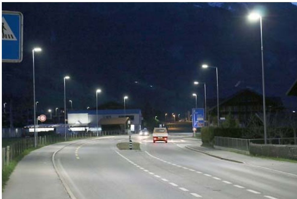
Un potentiel considérable d'économies énergétiques : les nouveaux lampadaires à LED sur la Kandertalstrasse au niveau de Frutigen.
