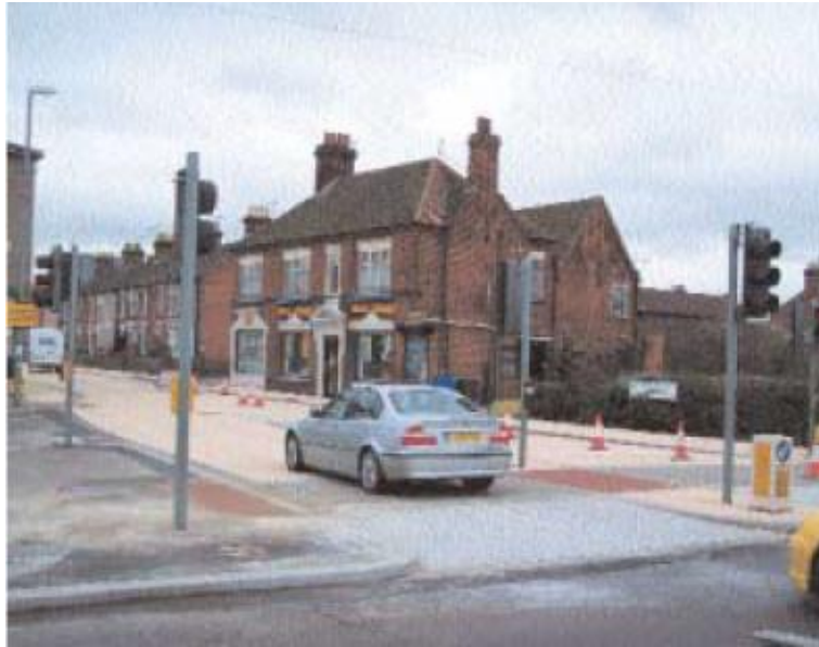
Le même carrefour après aménagement : la signalisation tricolore a été conservée (= mesure pour prise en compte des PAM ?)
