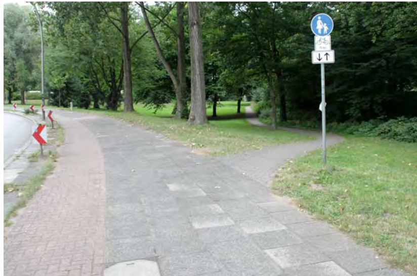
Abb. 21: Durchgangsweg zwischen Saarlandstraße und Saarlandstieg: umwegig und in sehr schlechtem Zustand.
