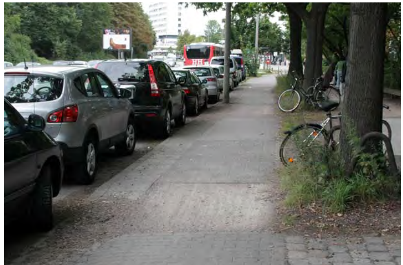
Abb. 31: Veloroute 5 West stadteinwärts: Starke Radwegschäden und stellenweise Ausbesserungen an der Adolph-Schönfelder-Straße zwischen Desenißstraße und Beim Alten Schützenhof.
