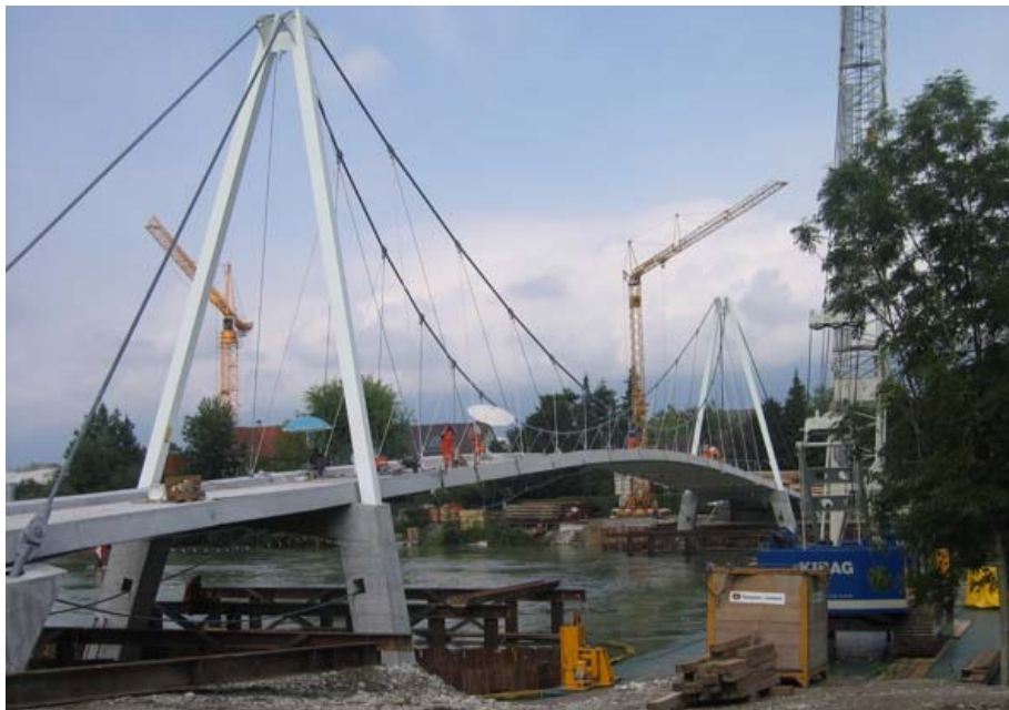
Blick aus Süden auf die Baustelle der Fussgänger- und Velobrücke entlang der Westtangente
