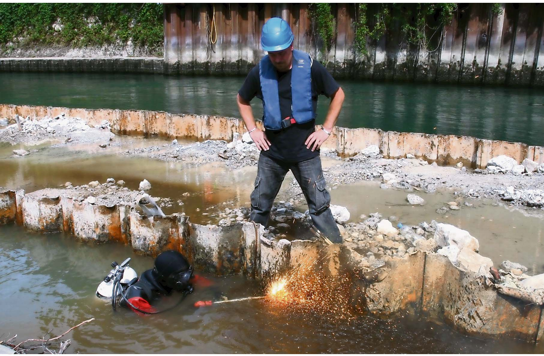
Arbeitstaucher David Wiederkehr bei Schneidarbeiten an der alten Wehrmauer in der Limmat beim Badener Kraftwerk Aue.
