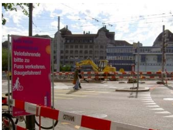
Vorbildlich: Es wird auf den Konflikt zwischen Fussgängern und Velofahrern aufgrund der Baustelle hingewiesen. (Bild: Zürich)
