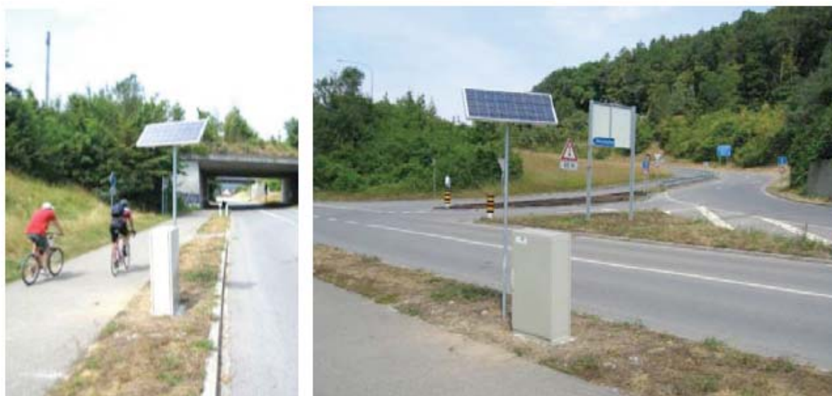
Bild 1: Zählstelle Hemishofen SH (Zählschrank mit Solarpanel)
