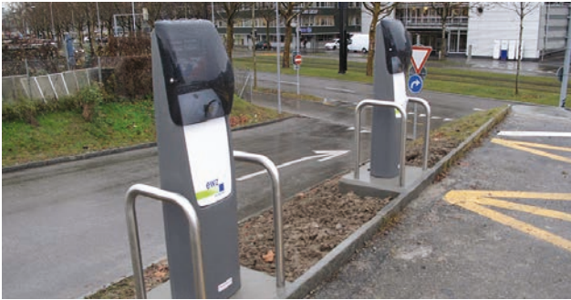
Figure 38 : borne de recharge normale/accélérée.
