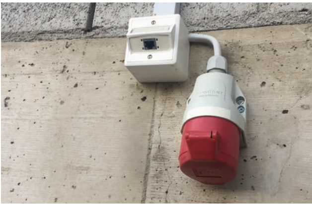
Figure 11 : dispositif optimal pour une future borne de recharge : prise CEE et connexion LAN.
