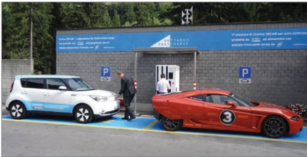
Figure 45 : première borne de recharge ultra-rapide à haute puissance (150kW) à Airolo, sur l'autoroute A2.
