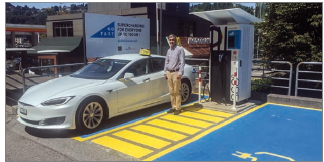
Figure 46 : borne de recharge ultra-rapide à haute puissance (150kW) auprès du McDonald's de Lugano Pazzallo.
