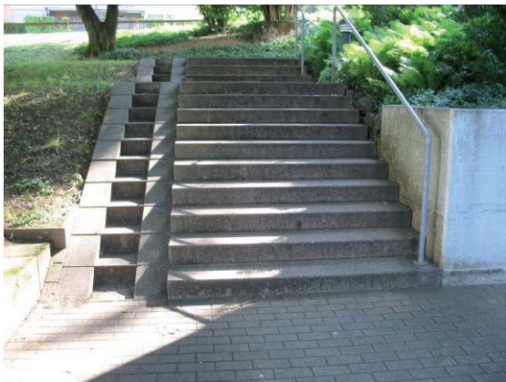
Die Hauszugänge sind nicht ideal. Sie sind nur über Treppen und steile Rampen erreichbar.
