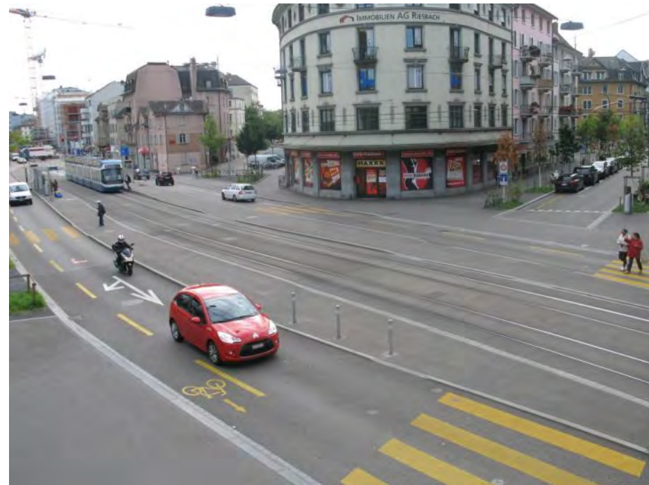
Lochergut, September 2013: Umbau Tramhaltestelle, Aufhebung Einbahnregime und Velomassnahmen Badenerstrasse, Abbruch Barriere für Nachtspernung Weststrasse, Ersatz mit permanenter Sperre
